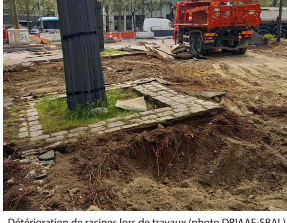
Détérioration de racines lors de travaux (photo DRIAAF-SRAL)
