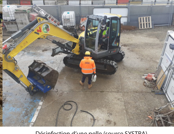
Désinfection d'une pelle (source SYSTRA)
