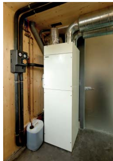
La production de chauffage et d'eau chaude est assurée par un seul équipement, équipé d'une pompe à chaleur et raccordé aux panneaux solaires.
